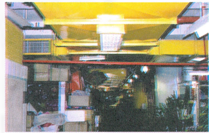
■西灣河街市內的中央冷氣系統
