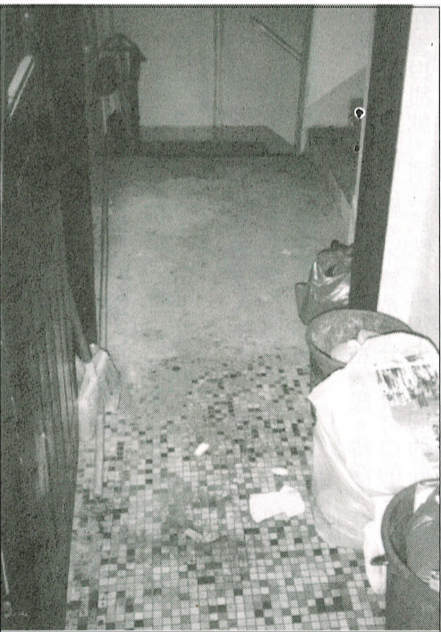
■梯間雜物阻塞走火通道。
