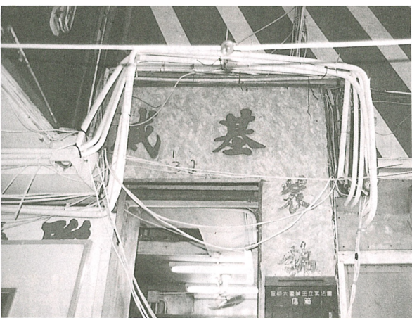
大火後的皇都大廈，電線交纏，情況似乎未見改善。
